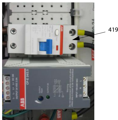
Рис. 32. Выключатель короткого замыкания на землю
